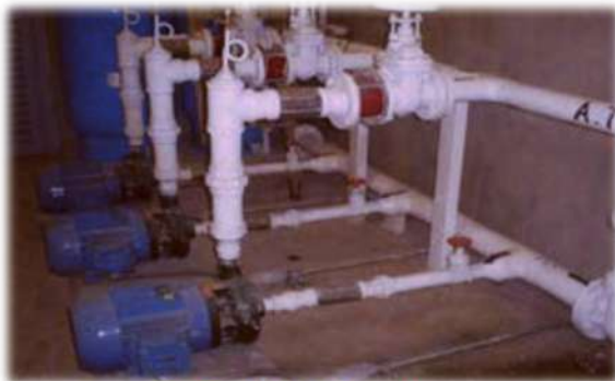
EQUIPO TRIPLEX AGUA TRATADA
