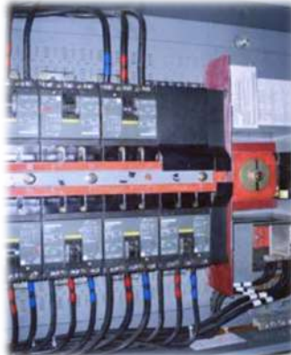
CABLEADO EN TABLEROS GENERALES
