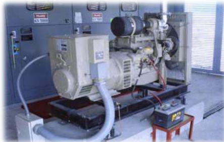
PLANTA DE EMERGENCIA Y SUBERSTACIÓN PRINCIPAL
