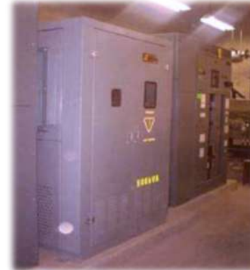
TRANSFORMADORES 500KVA Y TABLEROS
