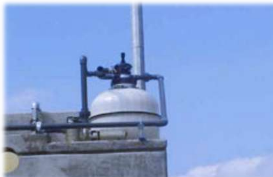
DILTRO PLANTA DE TRATAMIENTO
